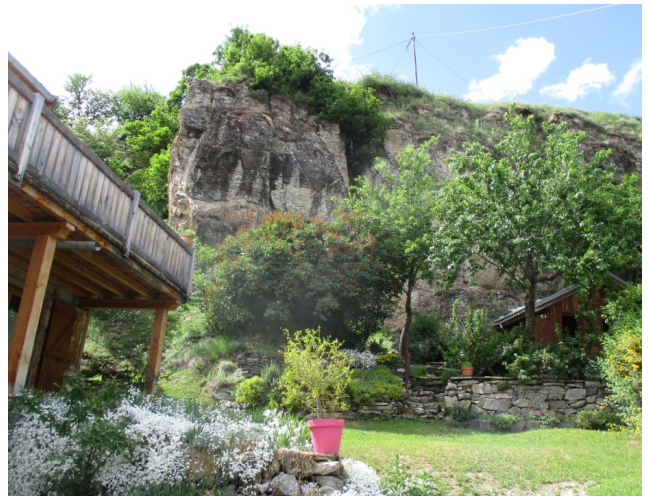
Figure 12: Talus rocheux route de l'oratoire de St-Roch.
