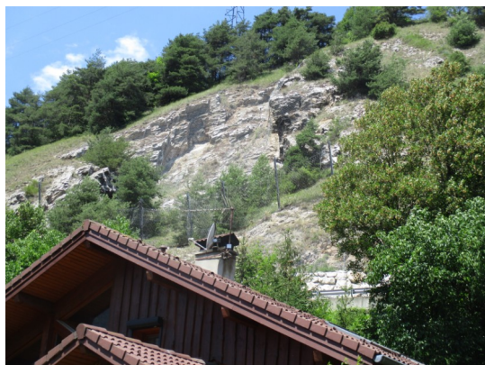
Figure 17: Filet tendu à l'amont de la RN90
