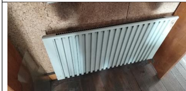
9 – Radiateur de chauffage
