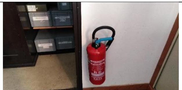
8 – Extincteur à eau
