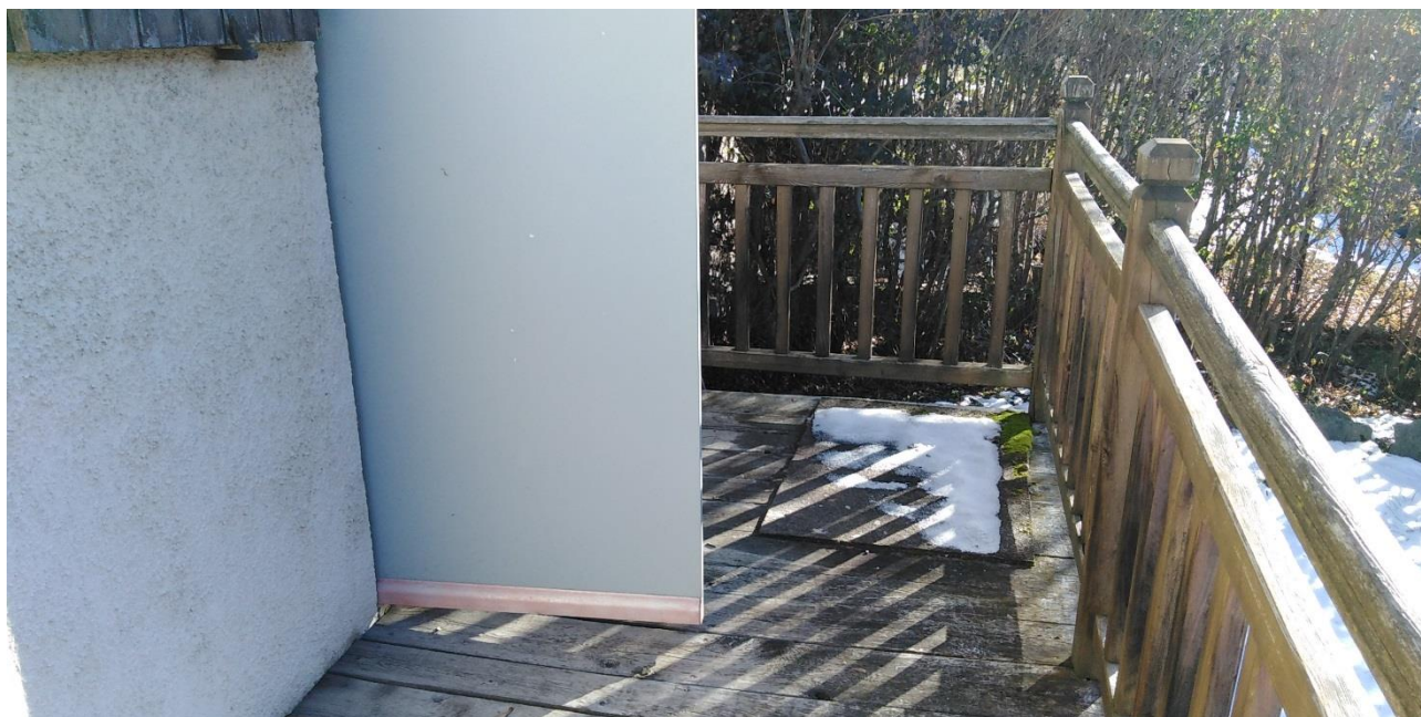
Palier de manœuvre de porte insuffisant (1.60 m X 1.47 m)
