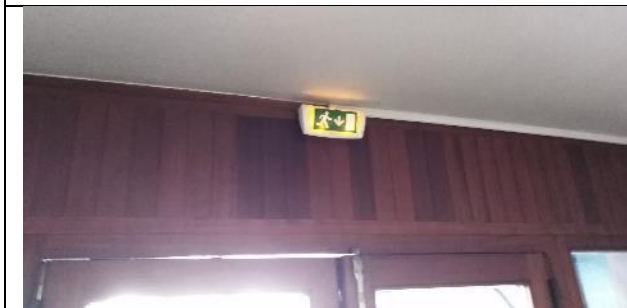
9 – Eclairage de sécurité
