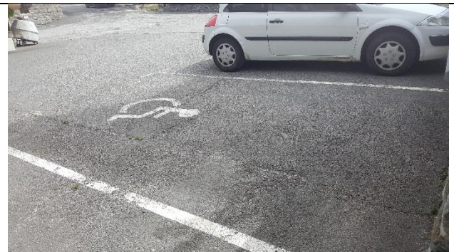
2 – Place adaptée existante non conforme
