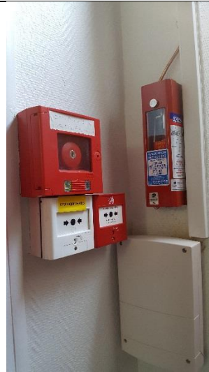
10 – Dispositifs en sécurité incendie
